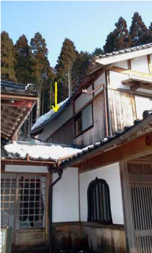
▲庫裡2階の屋根(矢印のところ)の垂木が折れました。
