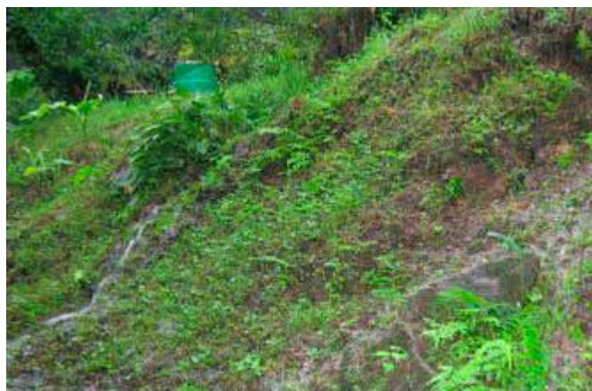
▲隠寮裏側も水が流れ出し、土手が崩れつつあります
